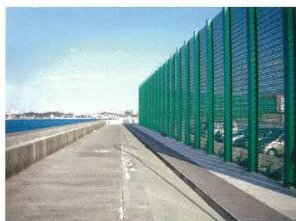
那覇港防風柵支柱(沖縄)
