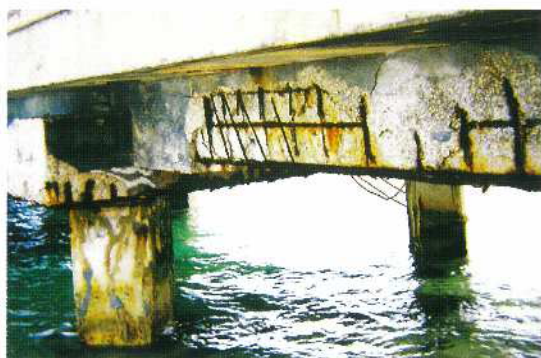
グアム ココス島棧橋の塩害写真 著しい鉄筋の腐食により、コンクリートが崩落
